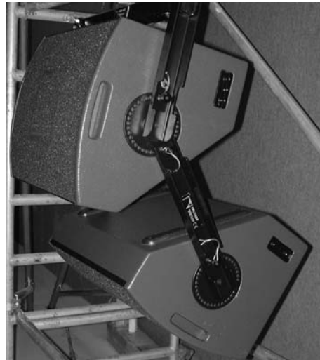
(10) Le système installé.
